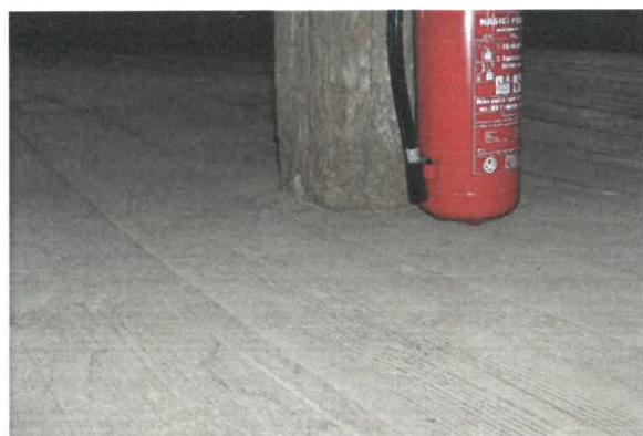
propadená podlahy u sloupu ve 2.NP
