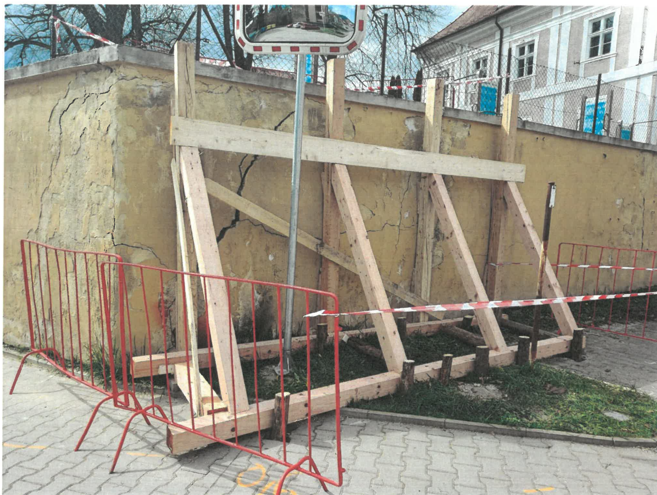
Aktuální stav opěrné zdi areálu zámku
