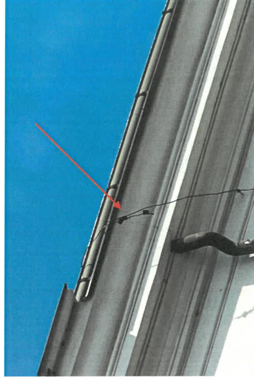
Pohled na umístění 1. svodu pod korunní římsou. Dole viditelná prasklina v římse. Tato porucha svědčí o pronikání vody do zdíva, pravděpodobně nestačí svod odvádět velké množství srážek.
