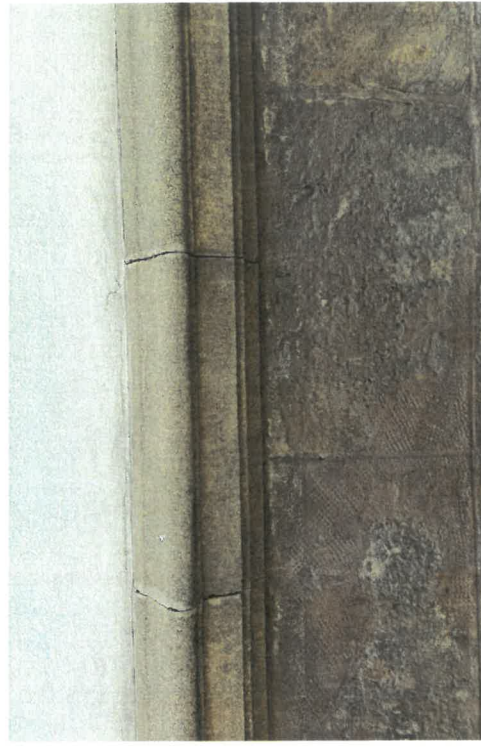
Nahoře vysunutá kamenné desky. Dole chybějící spárování průběžné římsy.
