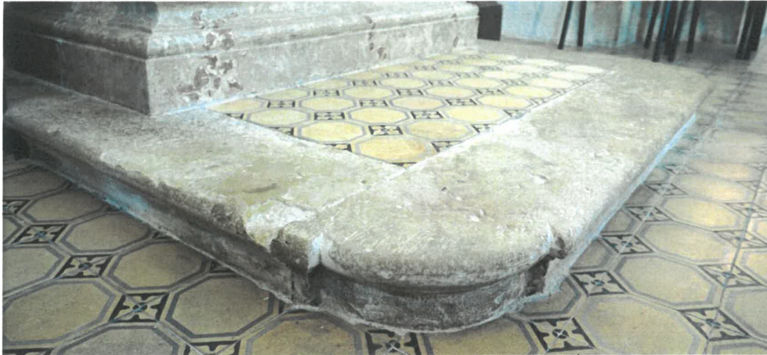
Obr.3. Typická poškození: lokální poškození profilace stupňů.
