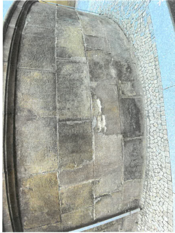
Nahoře viditelně oddělené tvarové doplňky do kterých zatéká voda. Dole obloukovité zakončení sakristie. Dožilé tvarové doplňky, vypadané části a praskliny ve spárování.
