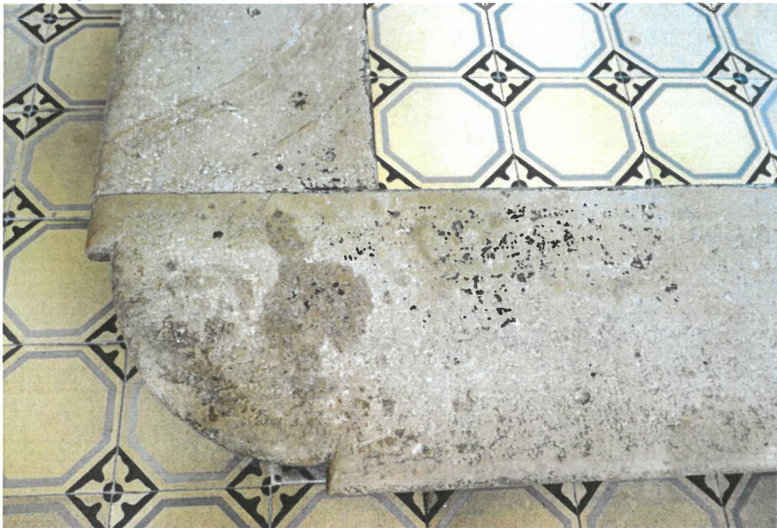
Obr.5. Typická poškození: znečištění povrchu mastnými skvrnami (asi od svíček) a černými zbytky patrně druhotných povrchových úprav (tmelů).
