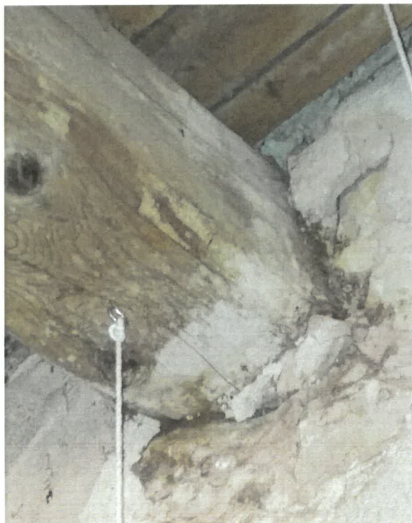
napadené zhlaví stropnic 1.NP
