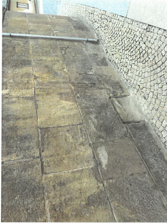
Nahore celkový pohled na část sakristie. Dole viditelné poškození spodního kamene.
