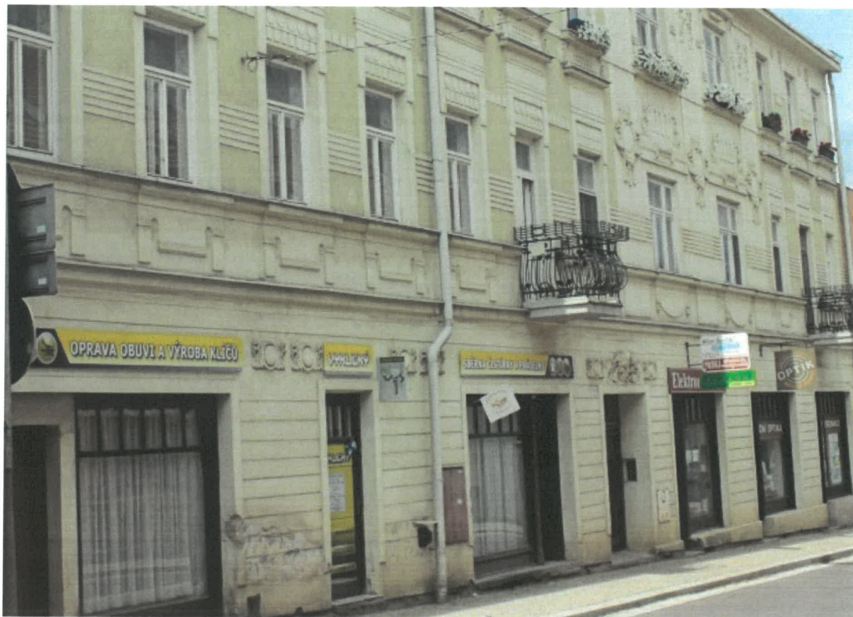
Průčelí městského domu čp. 71 před obnovou v r. 2017 a po obnově v r. 2018:
