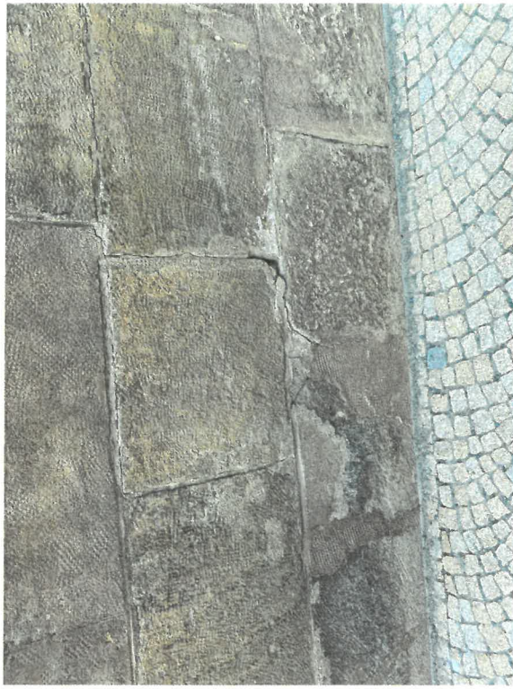
Trhliny způsobené zatékáním vody.
