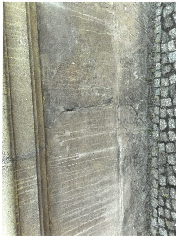
Chybějící spárovánína římsě, trhlna ve spáře způsobená zatékající vodou
