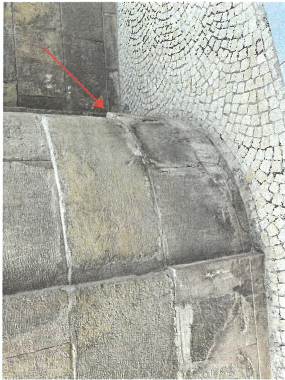
Nahore viditelné tvarové doplnky s trhlinami. Dole jsou vidět vysunutě konkávní kamenné desky.
