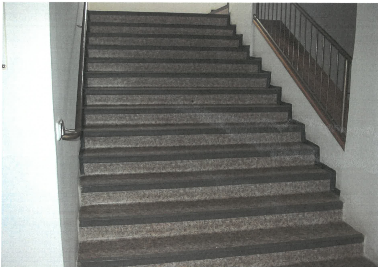
Zámek, ul. U Zámečku (vnitřní schodiště - nevhodné PVC vyměnit za dřevěné schodnice)
