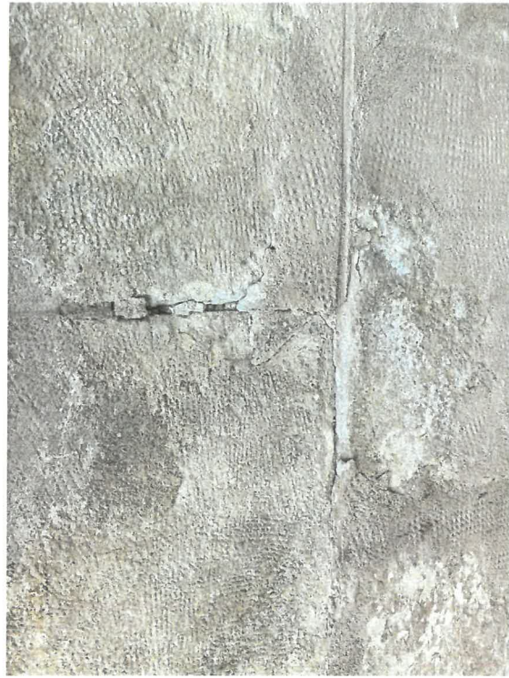
Nahofe vypadané spárování s tmavými tvarovými doplňky. Dole detail chybějícího spárování a odtržení tvarového doplňku od kamene.
